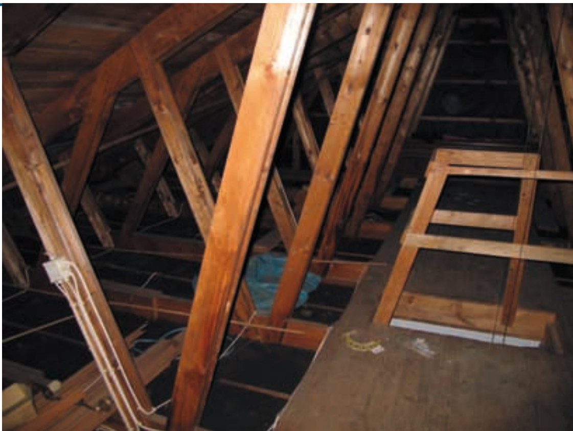
Dachstuhl eines hochgradig mit PCP und PAK belasteten Wohnhauses.
