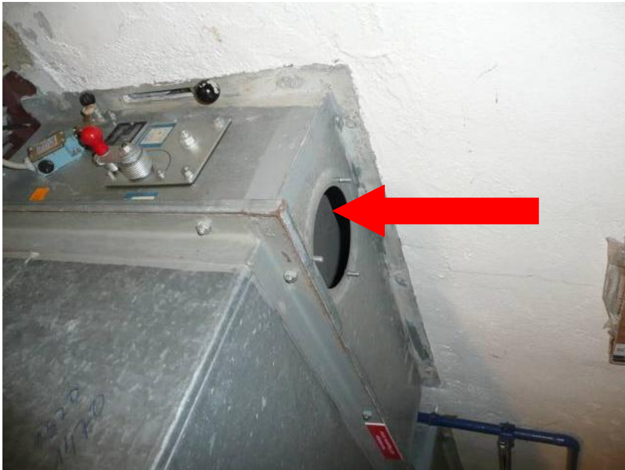
Asbesthaltige Brandschutzklappe in Lüftungsanlage
