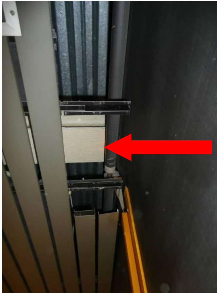
PCB-haltiger Brandschutzanstrich an einem Stahlträger
